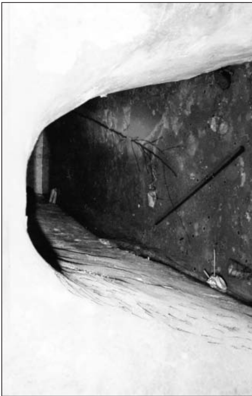
”Αποψη των κωδωνοσχημών άγωγών του ύδραγωγείου. Το νερό ακόμη λιμνάζει, ενώ η εικόνα της εγκαταλείψεως συμπληρώνεται με τα επιπλέοντα σ’ αυτό απορρίμματα. Διακρίνεται η θανμάσια επίστροψη των τοιγμάτων.
